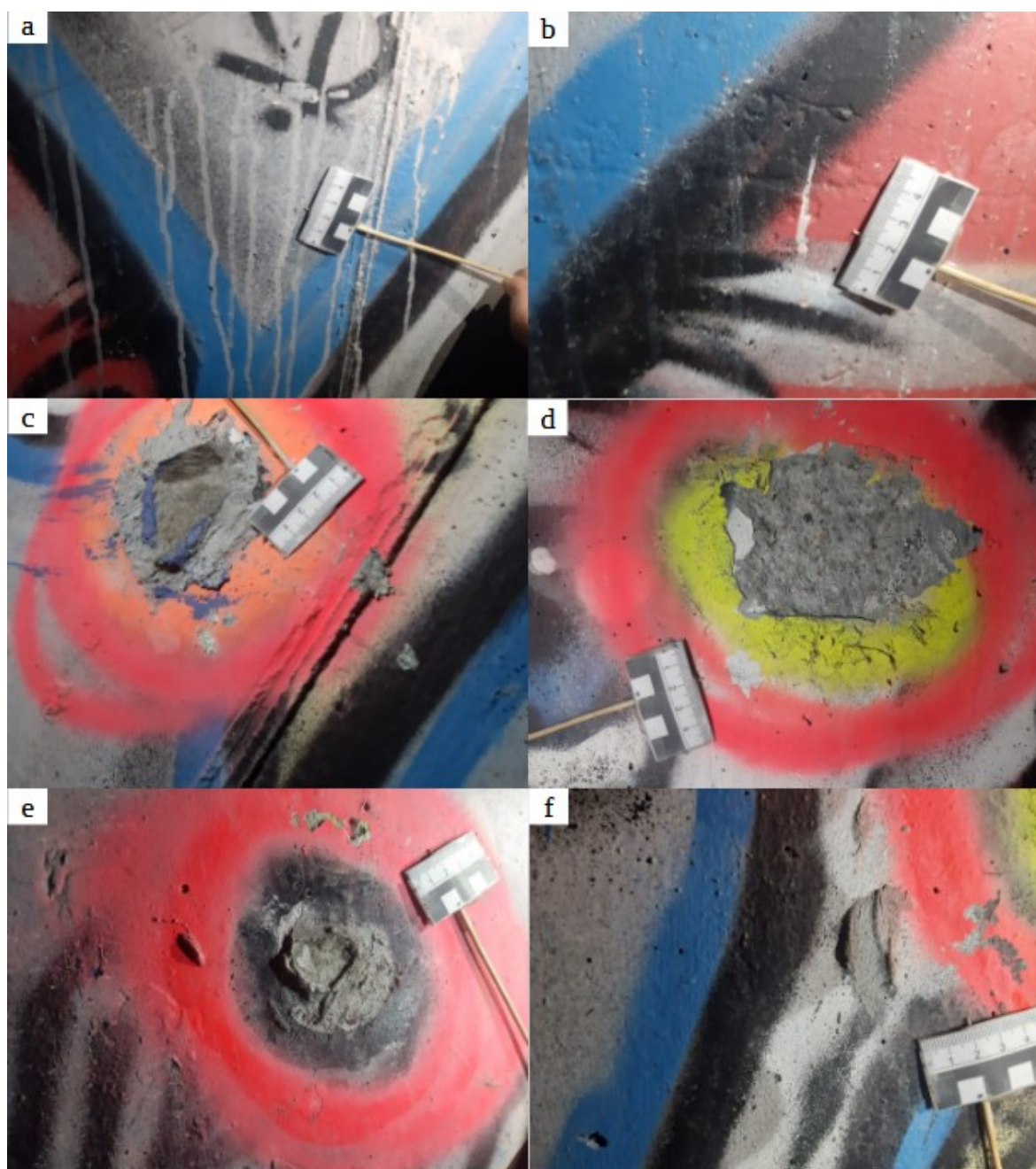
Figura 6: Formas de alteración atopadas no mural Bart. a: depósitos esbrancuxados // b: pinturas vandálicas // c: colapso // d: peeling // e: concreción // f: concreción
